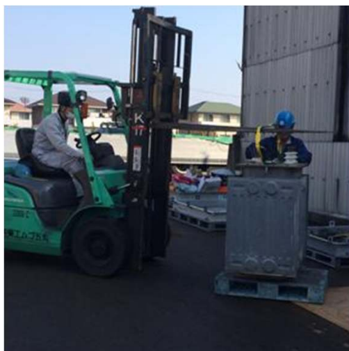
本社工場(トランス1台、汚染ドラム)2015.2.17
